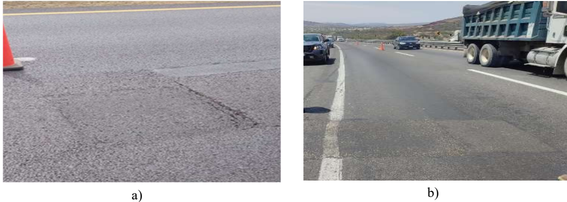
Figura 7. Bacheo en distintos sitios de la carpeta asfáltica
